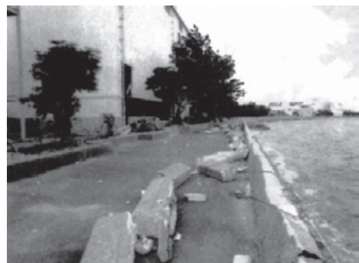
台風15号により決壊した護岸
