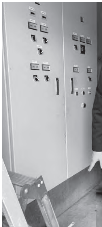
地面から配電盤までの高さを確認
