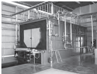
バークを燃料に蒸気を製造している
