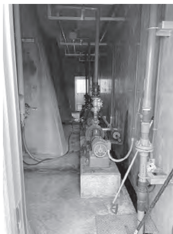
ブロワー機の確認
