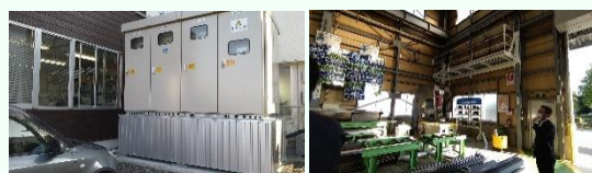
電源設備の嵩上げや高所に設備の避難場所を設けるなど、災害の教訓を活かした取組を行っている
